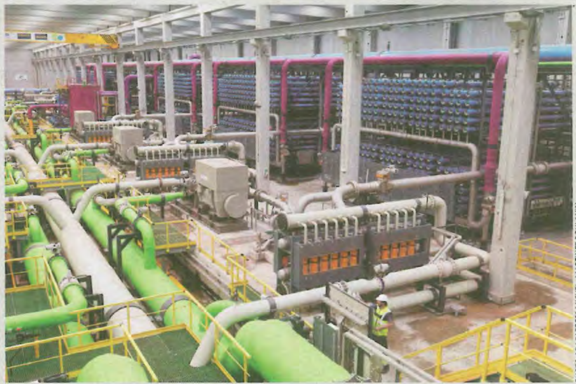
L'usine de dessalement à 10 km au sud de Barcelone.
